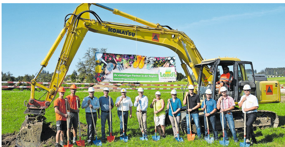
Alle an der Planung und am Bau Beteiligten legten Hand an und lancierten symbolisch die Bauarbeiten des Landi-Neubaus in Bazenheid.
